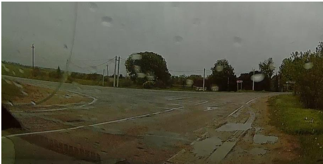
Рисунок 1.4.1 – Техническое состояние автомобильных дорог на перекрестке улица Центральная - деревня Ивановское
